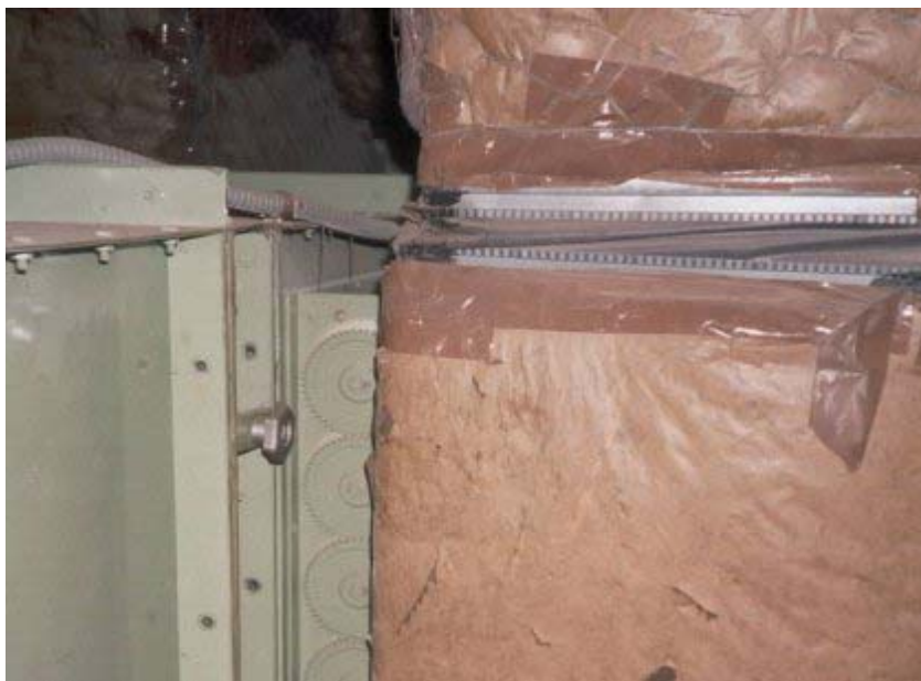
Conexión antivibratoria en una instalación de climatización entre la Unidad de Tratamiento de aire y el conducto de retorno.
